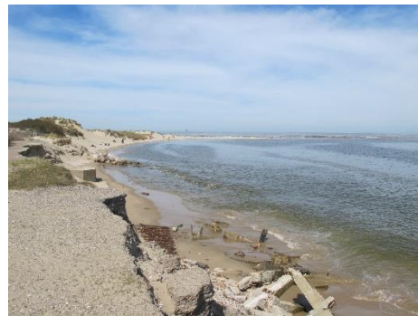
Baie de Canche, effondrement d'un aménagement causé par l'érosion du trait de côte
